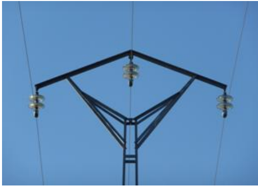
El tendido está formado por apoyos de metal con cruceta de bóveda con dos platos.
