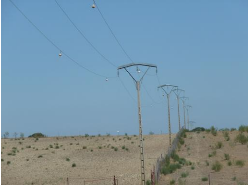
Imagen general de la línea a Los Hornos, en la que se aprecian las modificaciones efectuadas hace años, disuasores de posada y bolas anticollisión, algunas ya en mal estado.
