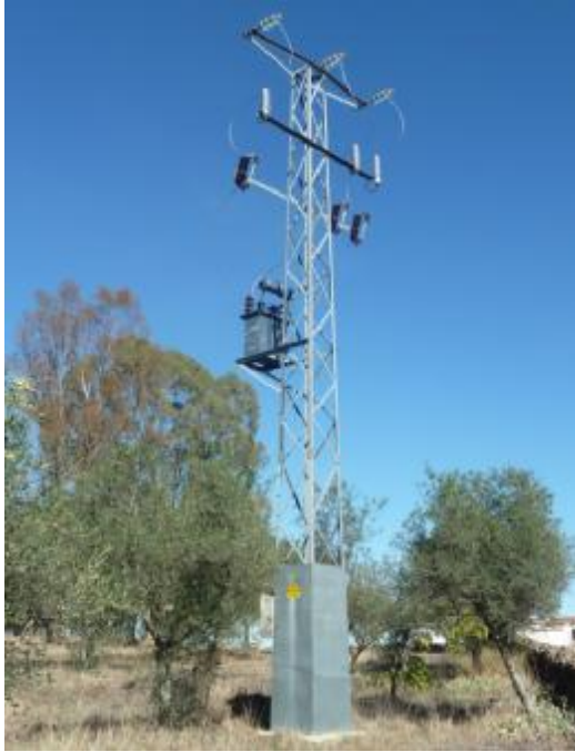
Apoyo transformador de fin de línea junto al Caserío El Cortijo.
