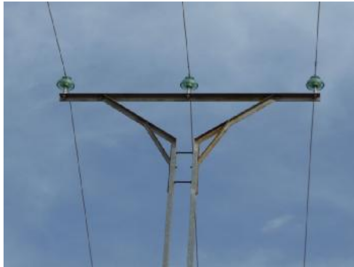
Todos los apoyos son de tipo aislador rígido con cruceta metálica, muy peligrosos para las aves.
