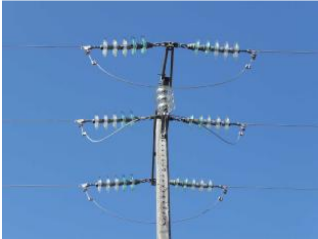
Apoyo 5062 hormigón en amarre modificado mediante alargamiento de cadena y aisladores suspendidos en la fase central.
