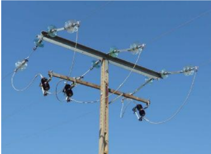
Apoyo CC01276 con alargadera inicio de la derivación a Clavería coordenadas 662579 4381056
