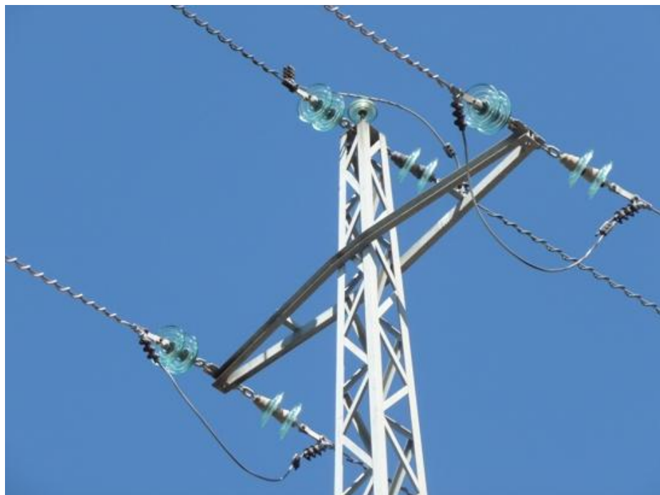
Apoyo N° 5137 coordenadas 29S0753462 4412856 responsable de la mayoría de las electrocuciones, en este caso un joven de buitre leonado.
