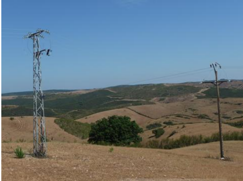
Apoyo N° 1110 derivación de línea a la Finca Majada Alta y apoyo N°1 CC00984 inicio de línea. Coordenadas 633403 4388433
