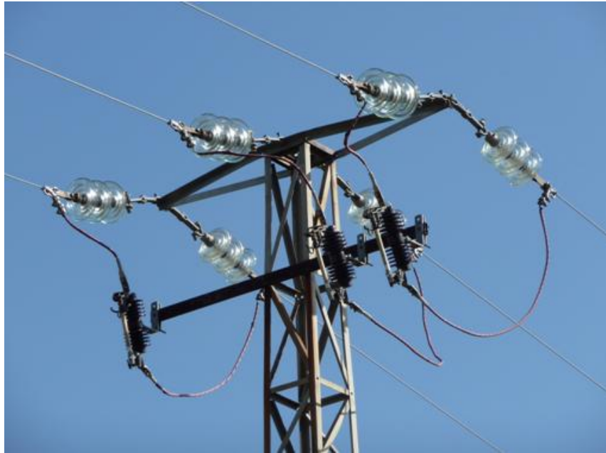
Apoyo CC 01247 primero de la línea derivación a la Finca El Baldío, con los cables del seccionador aislados.
