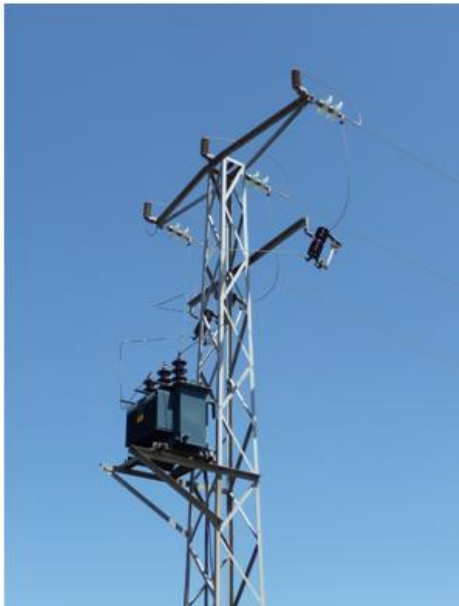
Apoyo transformador final de línea con los conductores desnudos por encima de la cruceta situado junto a las instalaciones ganaderas y vivienda.
