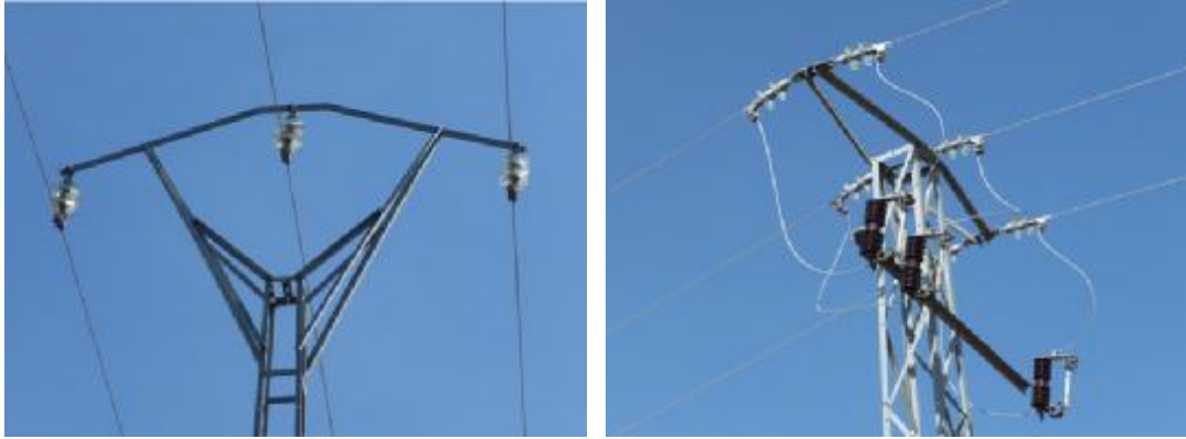
A la izquierda foto del tipo de apoyo que conforma la línea y a la derecha imagen del apoyo final junto al abastecimiento de aguas de Cedillo.
