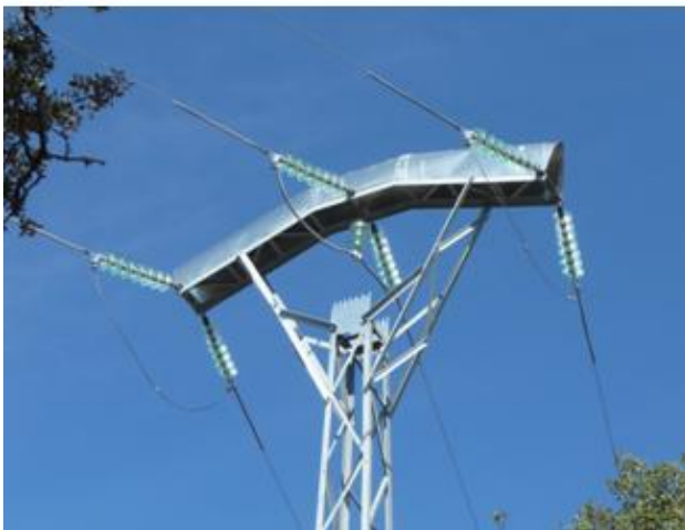
Apoyo 14 modificado con disuasor de posada en centro de cruceta y parte superior, aislamiento silicona en puente central y cables.
