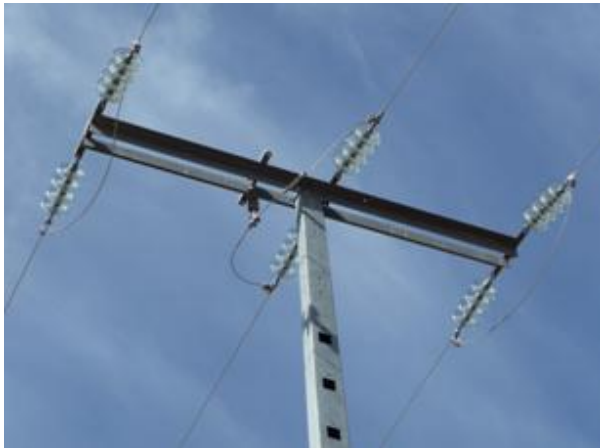
Apoyos de tipo amarre con cuatro aisladores conforman la línea en su totalidad.
