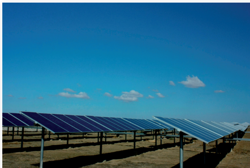
Fotografía 4.3.1. Paneles solares en una instalación fotovoltaica.
