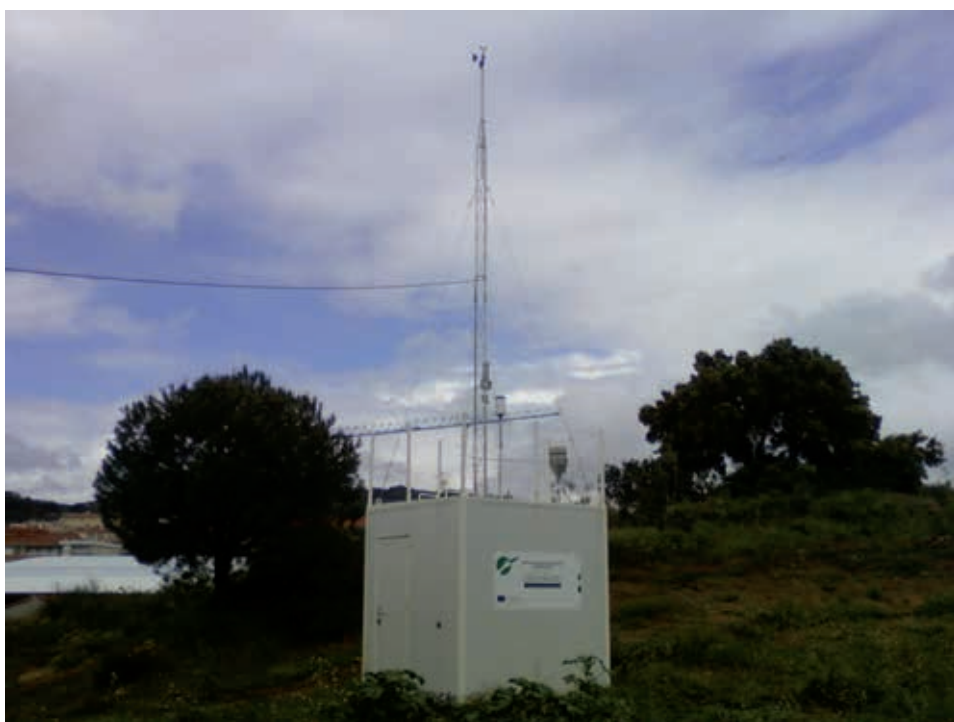
Figura 10. Cabina de calidad del aire de la red REPICA situada en Plasencia en I.E.S.
