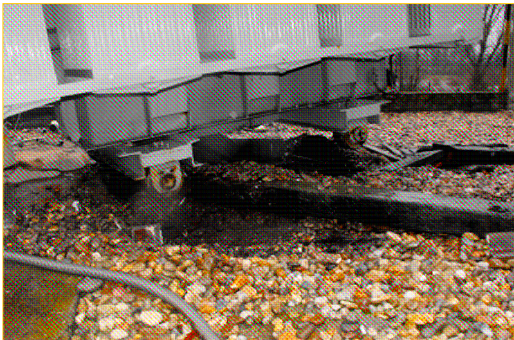
Fotografía: Vertido de aceite térmico de transformador
