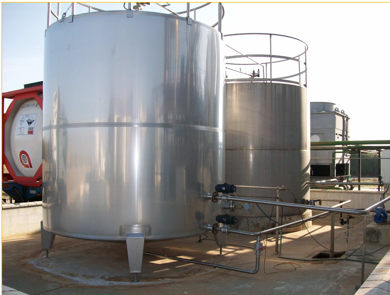
Fotografía: Imagen de Instalación industrial en Extremadura
