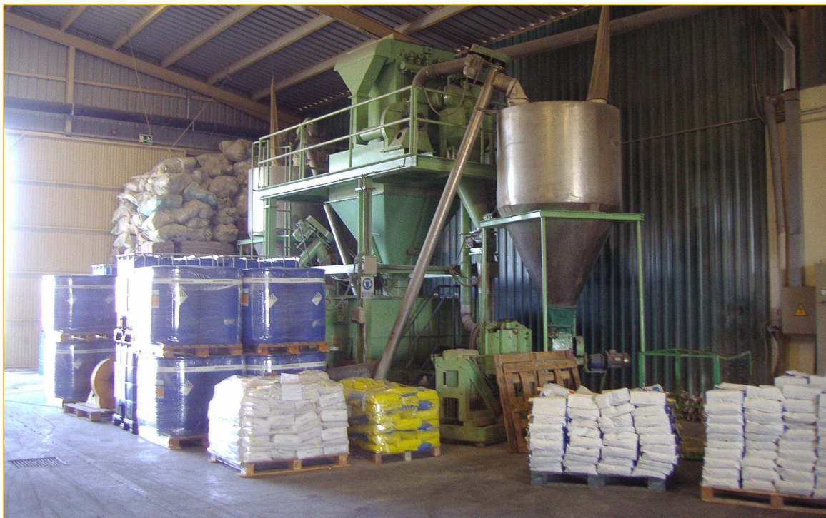
Fotografía: Imagen de Instalación industrial en Extremadura
