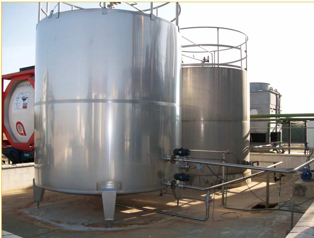
Fotografía: Imagen de Instalación industrial en Extremadura
