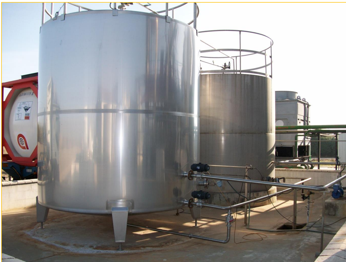
Fotografía: Imagen de Instalación industrial en Extremadura
