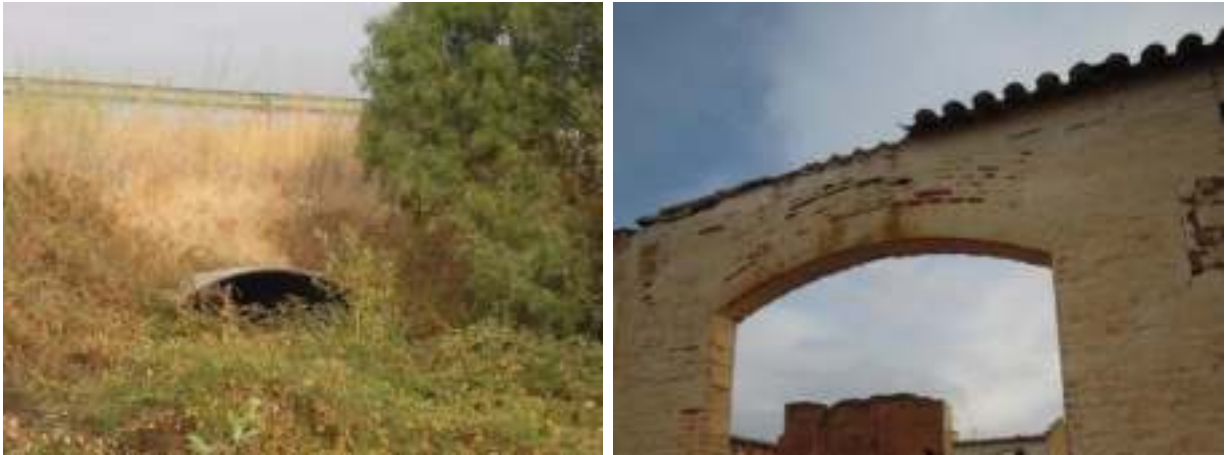
Ilustración 7.- Tubo para el paso del Arroyo Hediondo bajo la carretera y cortijo abandonado.
