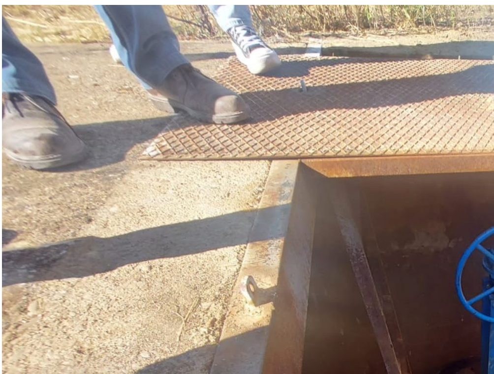
Foto. Detalle de la toma en interior arqueta de toma
