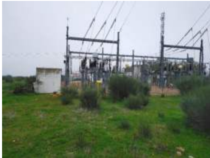
Subestación eléctrica "CERRO GORDO".
