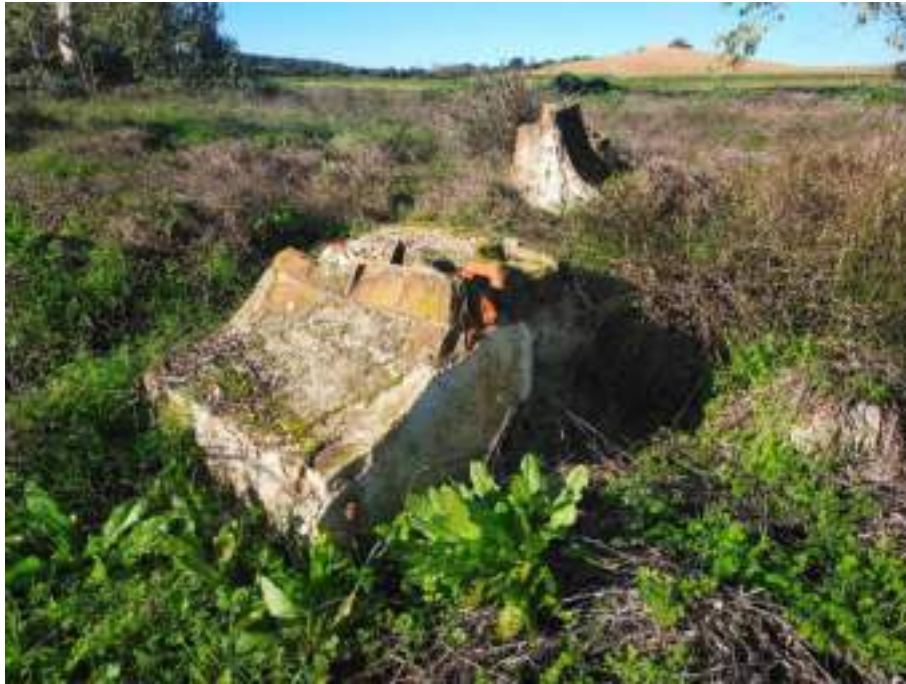
Arcos en ruina de la pasarela.
