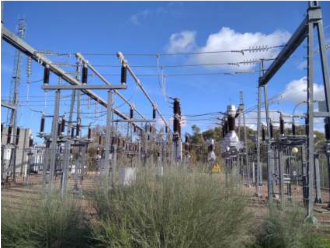
Imagen: Fin de la Línea en Subestación Cerro Gordo de Badajoz.
