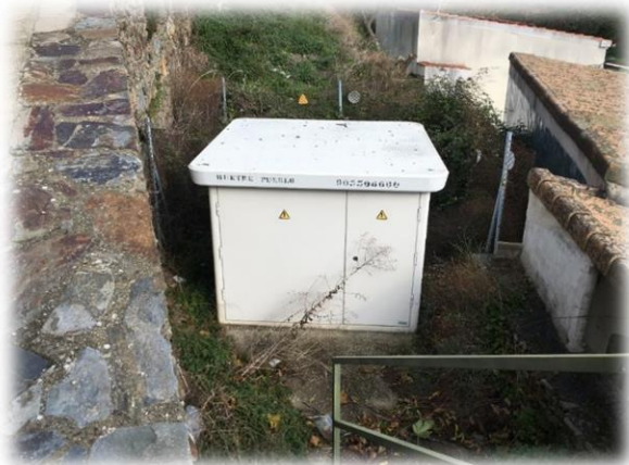
CT “Huetre Pueblo” donde finalizará la nueva LSMT proyectada
