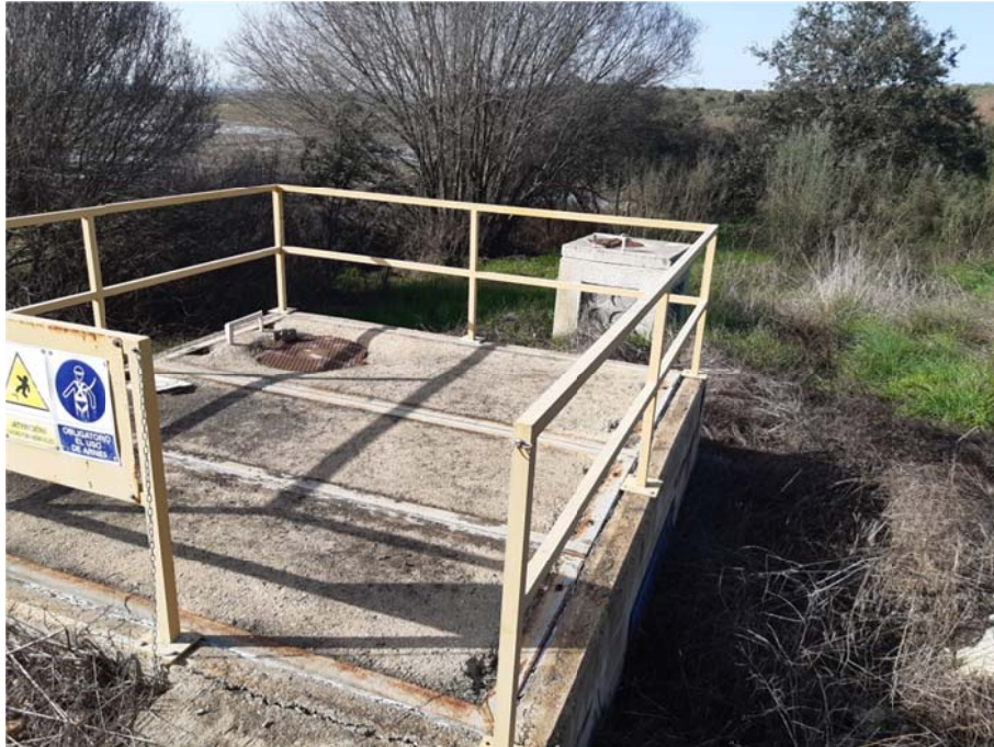
Arqueta de toma propiedad de la CHG
