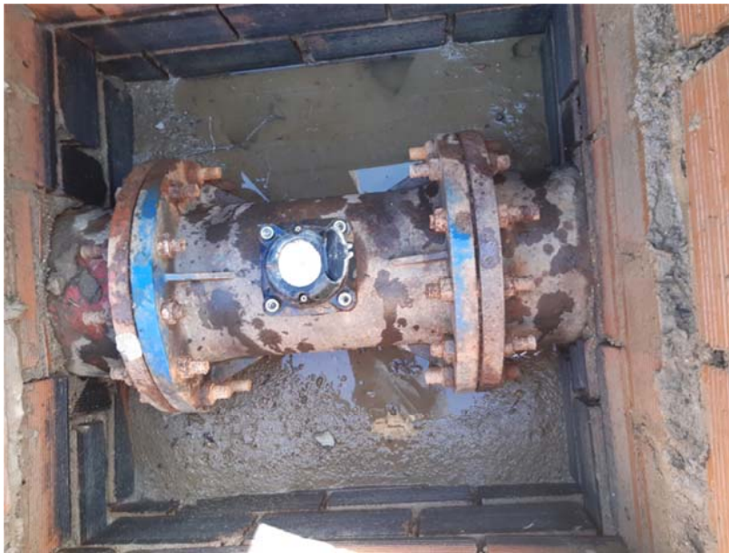
Contador tangencial en el interior de la arqueta
