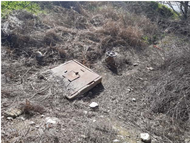
Arqueta donde se aloja el contador tangencial junto a la válvula de compuerta
