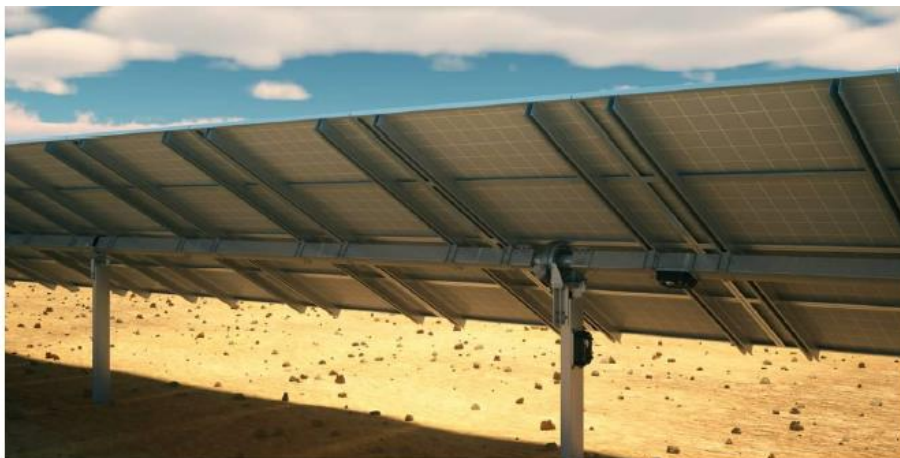
Figura 5. Estructura de seguidor fotovoltaico.
