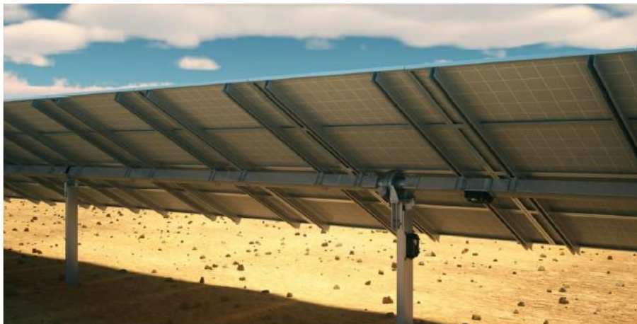
Figura 5. Estructura de seguidor fotovoltaico.
