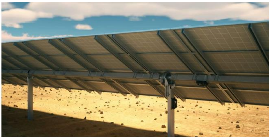
Figura 5. Estructura de seguidor fotovoltaico.
