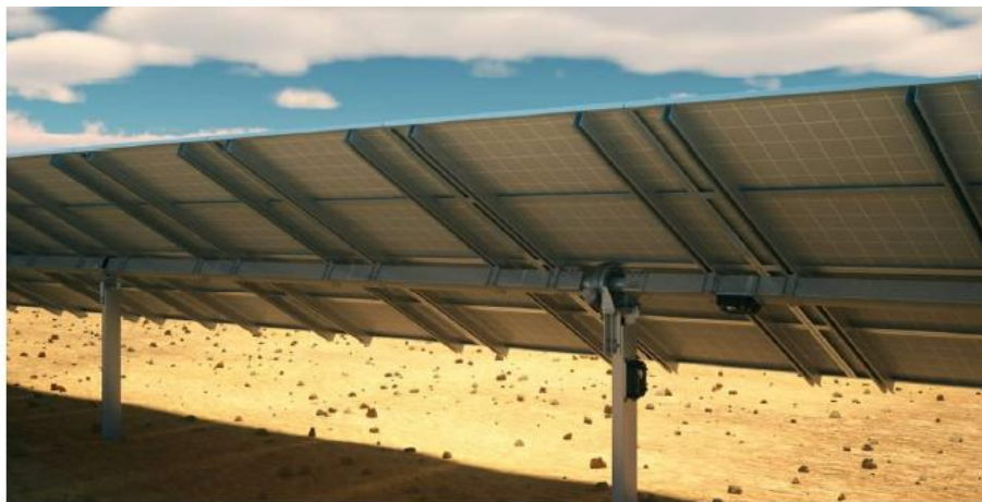
Figura 5. Estructura de seguidor fotovoltaico.
