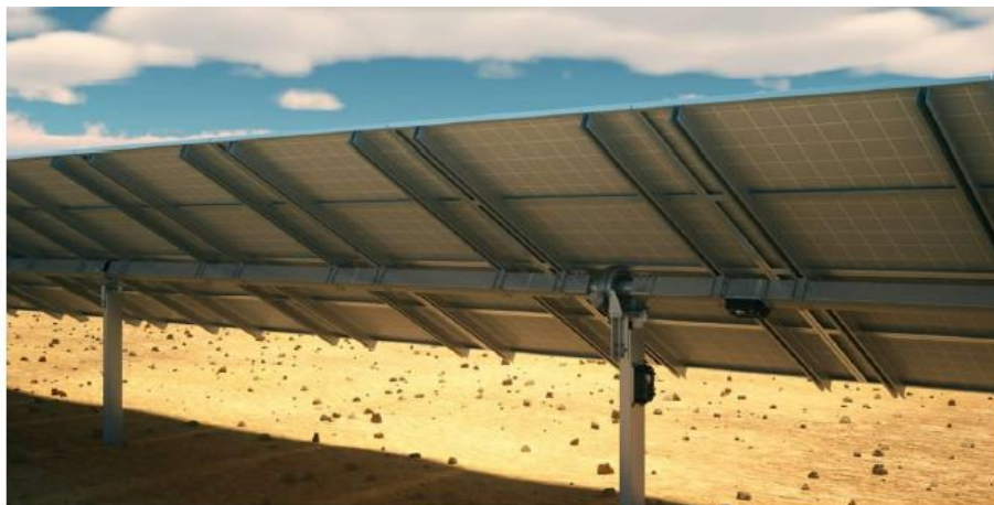
Figura 5. Estructura de seguidor fotovoltaico.
