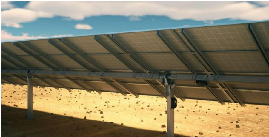
Figura 5. Estructura de seguidor fotovoltaico.
