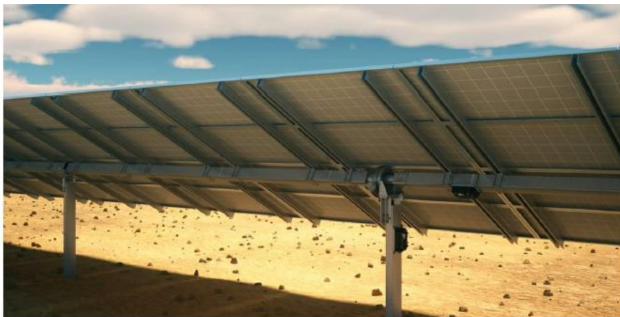
Figura 5. Estructura de seguidor fotovoltaico.
