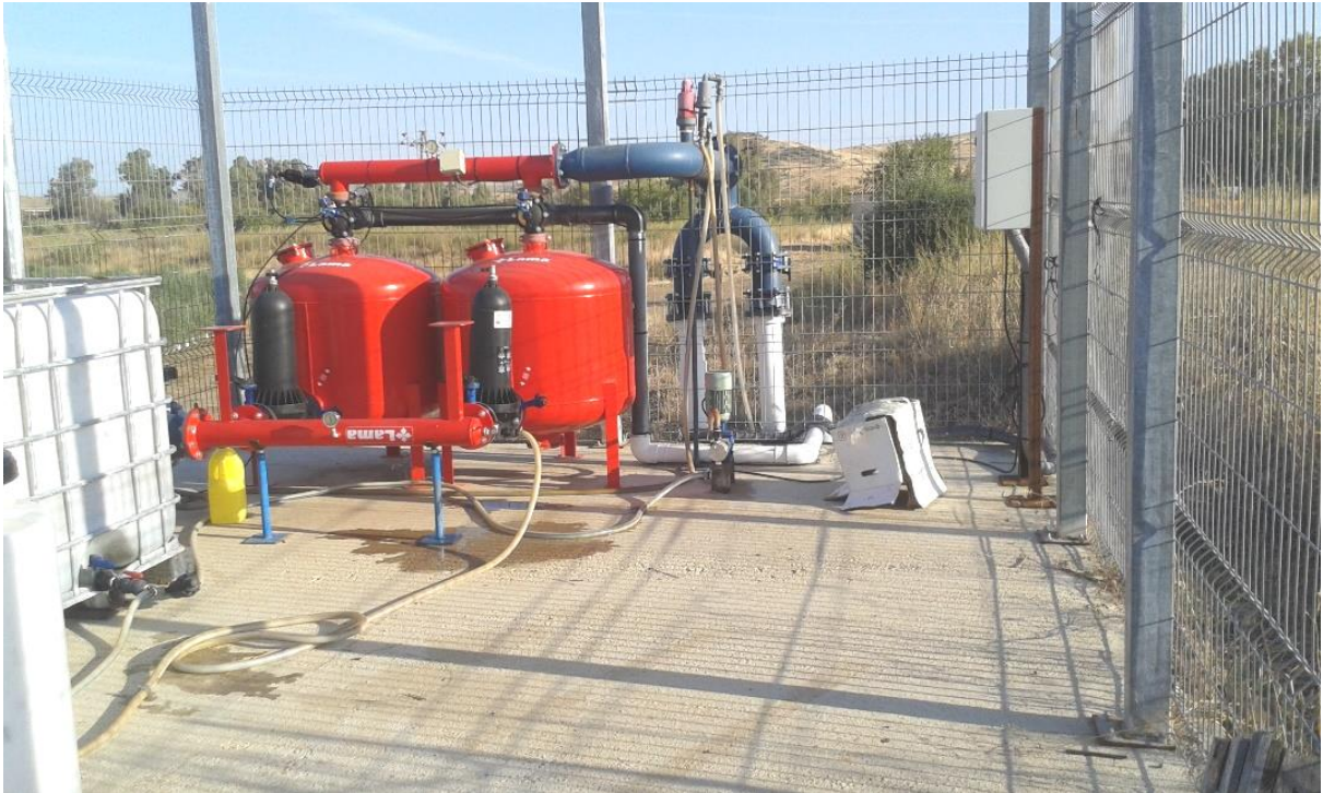
IMAGEN 4. EQUIPO DE FILTRADO Y FERTIRRIGACIÓN INSTALADOS
