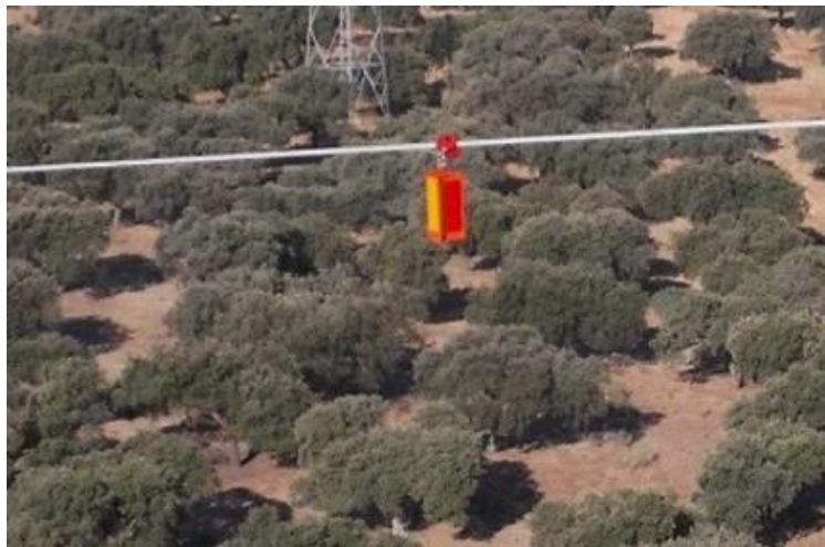
• Vista del dispositivo instalado en el cable de tierra
