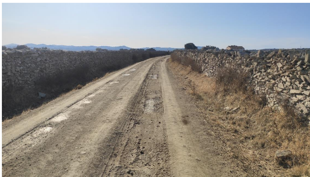
Fotografía 73. Vista del estado de la vía pecuaria Vereda de Jerez de los Caballeros entre la poligonales 3 y 4. Se encuentra en buen estado.
