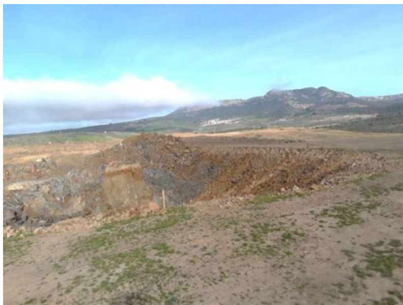
Imagen 1: Estado actual de la balsa. En la imagen se observa los trabajos realizados en la misma.
