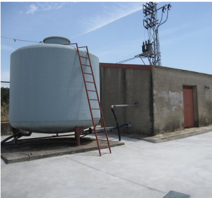
Imagen 9.-Depósito de acumulación 1 y sala de máquinas.
