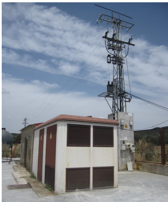
Imagen 8.-Poste eléctrico y centro de transformación de la Industria.
