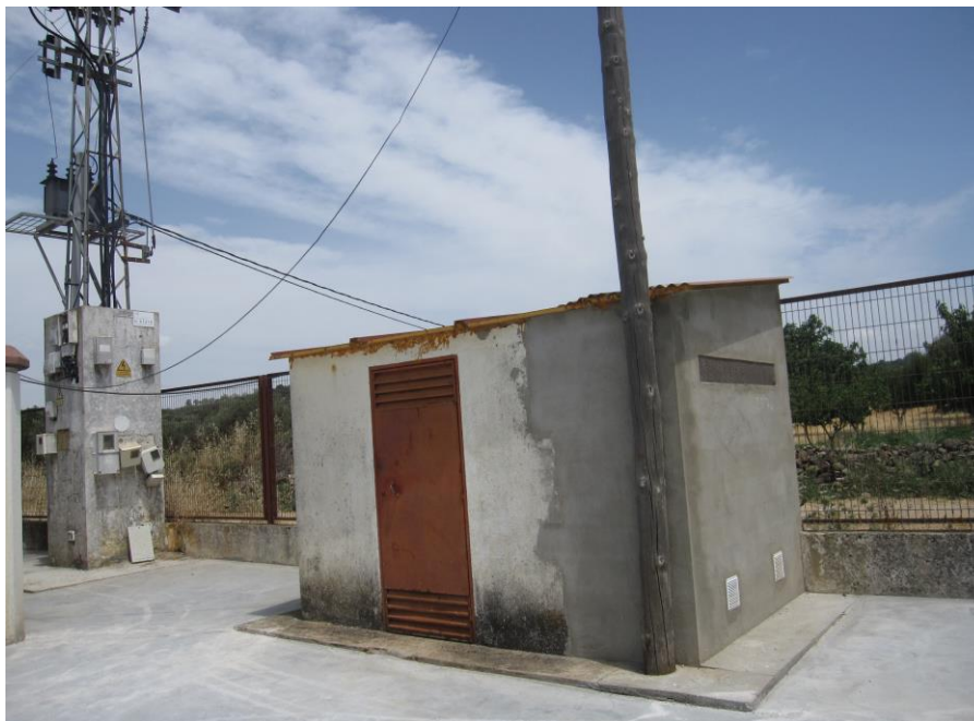
Imagen 10.-Poste y caseta de línea telefónica.
