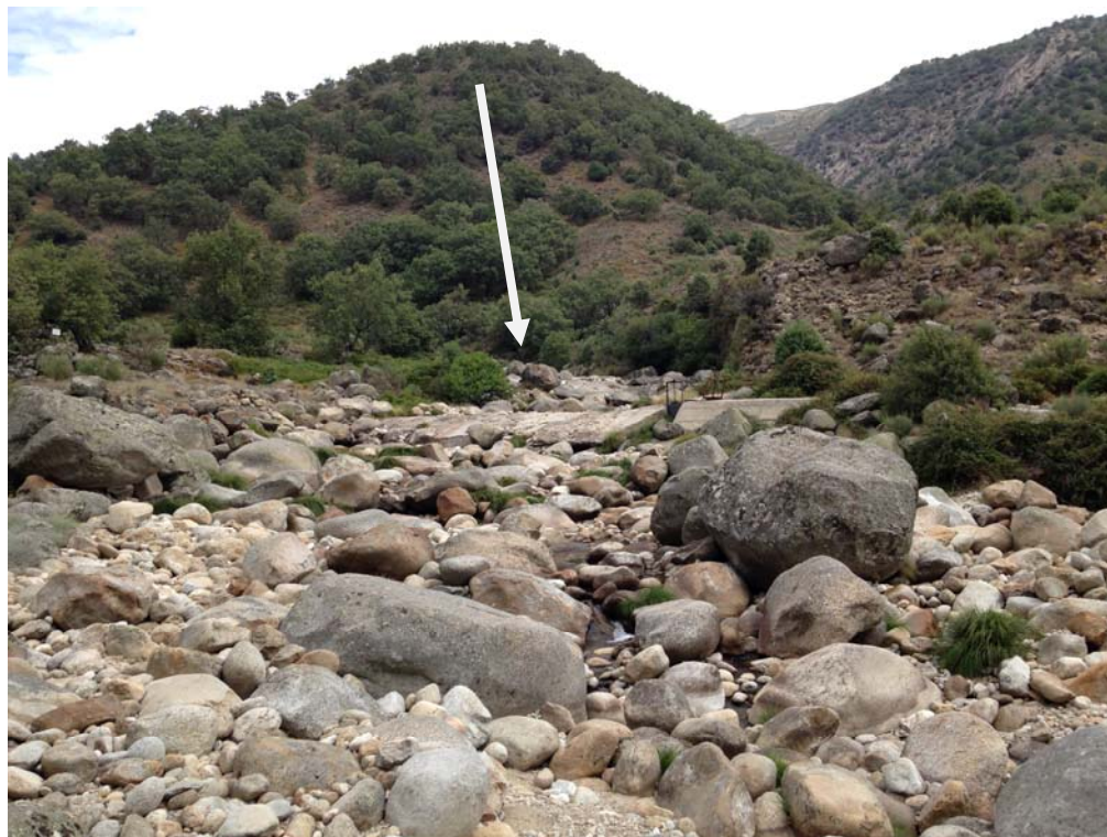
En primer plano el azud de la toma de la conducción de Viandar y de la minicentral. Al fondo, señalado con una flecha, la posición del nuevo azud.
